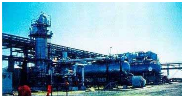
Рис. 1 Установка ДМС-1 на Тенгизском ГПЗ
