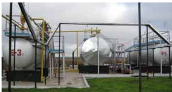
Рис. 3 Установка «СЕРОКС-ГАЗ» в ЗАО «Троицкнефть»
