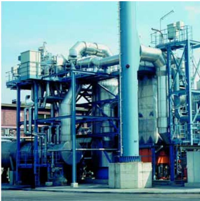
Рис. 1 Установка WSA Топсе на НПЗ
