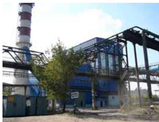
Электрофильтр ФИНГО системы аспирации доменной печи №5 ОАО «НЛМК»
