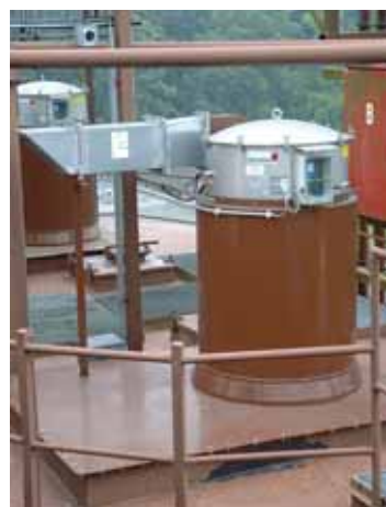
Рис. 6. Фильтры INFASTAUB, установленные на бункерах.
