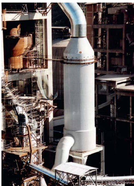
Рис. 4. Установка для кондиционирования газов на заводе Rio Branco, Бразилия
