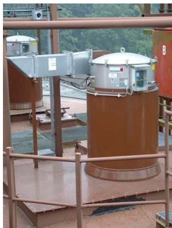
Рис. 6. Фильтры INFSTAUB, установленные на бункерах.
