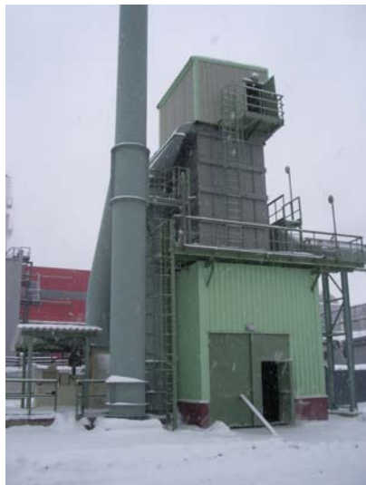
Рис. 4. Фильтр INTENSIV, установленный на ООО «ОМК-Сталь»
