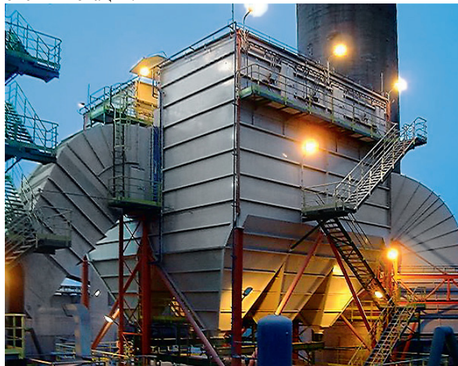
Рис. 1. Рукавный фильтр DPD на цементном заводе Hoghiz, Румыния
