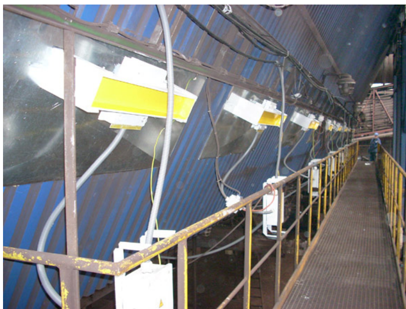
Рис.5 Внешний вид бункеров сбора пыли электрофилтра, оснащенных установкой ИМЗ-1,2-9
