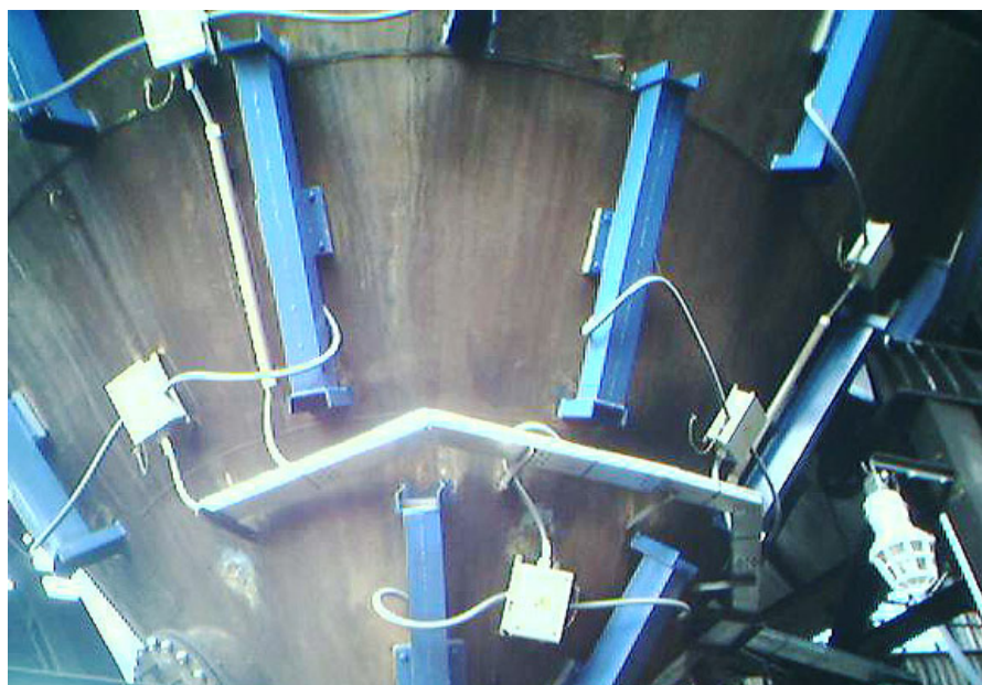
Рис.4 Внешний вид конусной части пылеулавливающей башни, оснащенной установкой ИМ4-1,6-12
