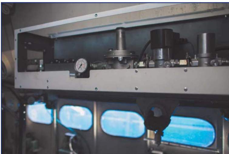
Рис. 2. Комплект навесного газового оборудования для подачи природного газа, размещенного на боковой стенке машинного отделения судна-газохода "Нева-6"
