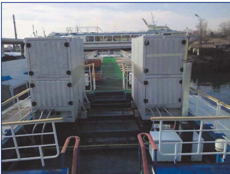
Рис. 4. Быстросъемные криогенные модули СПГ, установленные на фундаменте из металлических двутавровых балок (верхняя палуба теплохода "Нева-6")
